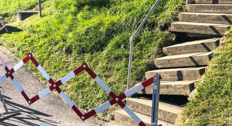
Wilerhalteweg, unterspülte Treppe zur Kapelle
